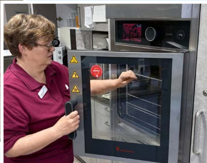
Die neuen Kombidämpfer wurden eingebaut
